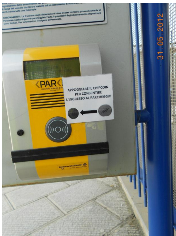
Foto 5 – LETTORE DI CHIP COIN PER APERTURA PORTA DI ACCESSO PEDONALE
